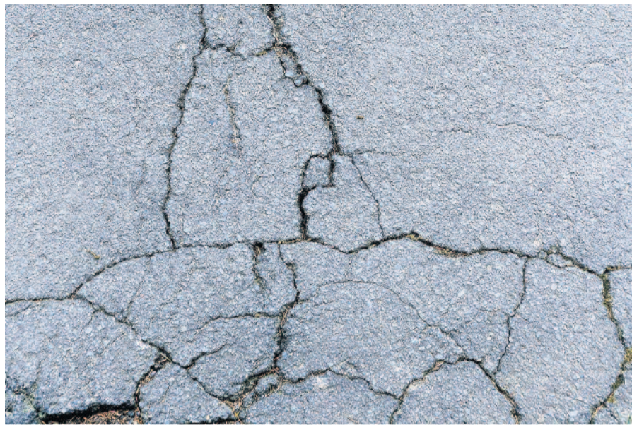
Die hohe Verkehrslast auf der S177 in den Ortslagen Seifersdorf und Feldschlößchen fordert ihren Tribut. Die Fahrbahn ist brüchig, Schlaglöcher entstehen. (Foto: pixabay)
