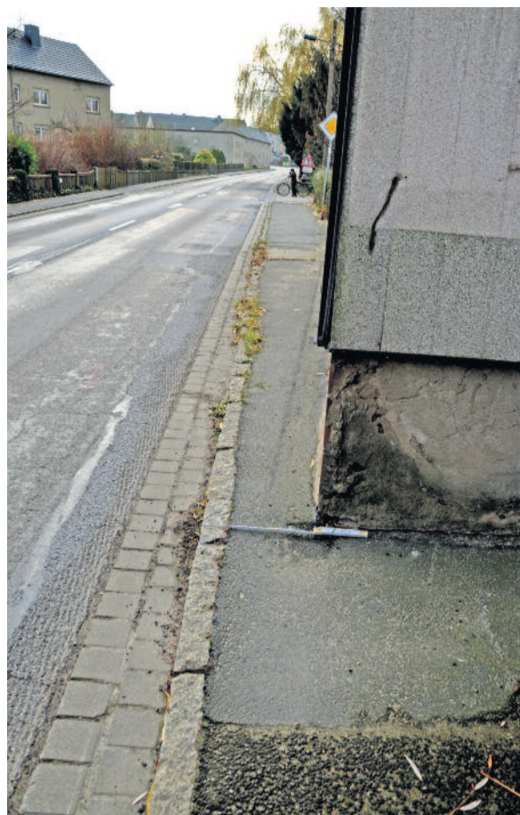
In der Ortslage Seifersdorf geht es nicht nur um die Erneuerung des Asphalttes, sondern auch um den grundhaften Ausbau unter anderem mit neuen Fuß- und Radwegen. Dafür macht sich auch der Ortschaftsrat stark. (Foto: J. Puruckherr)
