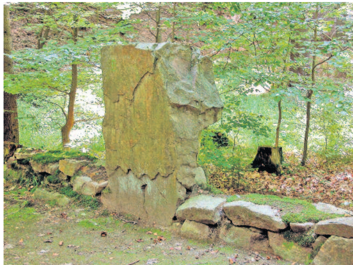
Der Wanderweg an „Lorenzos Grab“ bleibt bis zur Beseitigung der Gefahr gesperrt. Die Umleitung auf den Weg entlang der Röder gestattet weiterhin das Durchwandern des Tals. Eine imposante alte Buche unmittelbar am Denkmal stellt aktuell eine große Gefahr dar.
